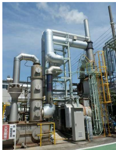
写真: 廃水焼却炉
